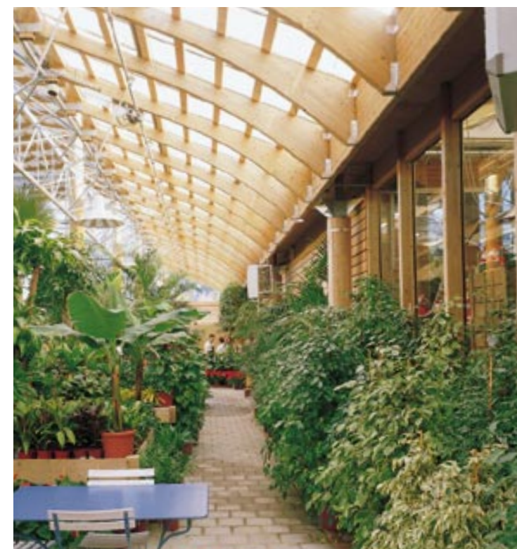
▲ Dans la serre, les arbalétriers en lamellé-collé supportent une toiture en polycarbonate alvéolaire qui procure la luminosité nécessaire aux plantes.
